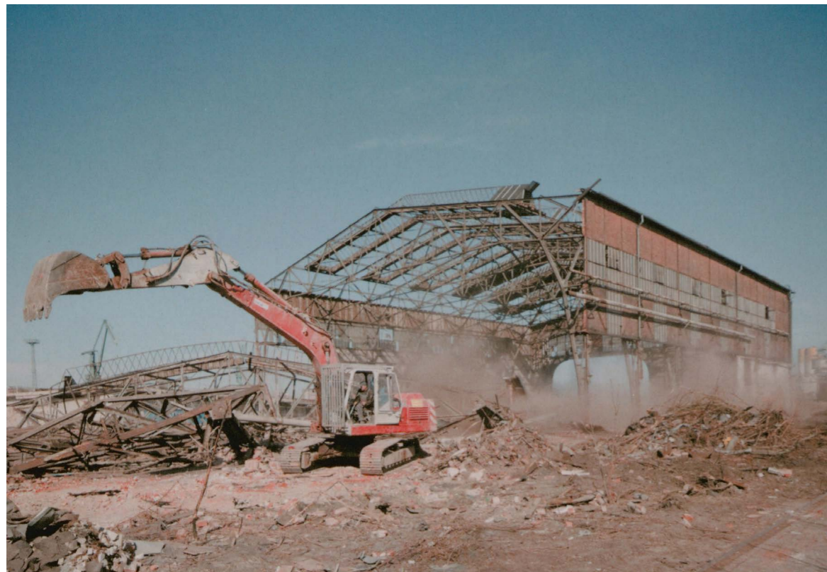
II. 52. Rozbiórka jednej z ciekawszych hal stoczniowych – hali 1A, wchodzącej w skład Wydziału Budowy Kadłubów K-2, a wcześniej hali wyposażeniowej Stoczni Cesarskiej (Pfundgrabenhalle) wykorzystywanej min. w procesie produkcji pierwszych U-Bootów, fot. M. Szłaga, z cyklu pt. Paskudne Pocztówki , 2012, zbiory autora
