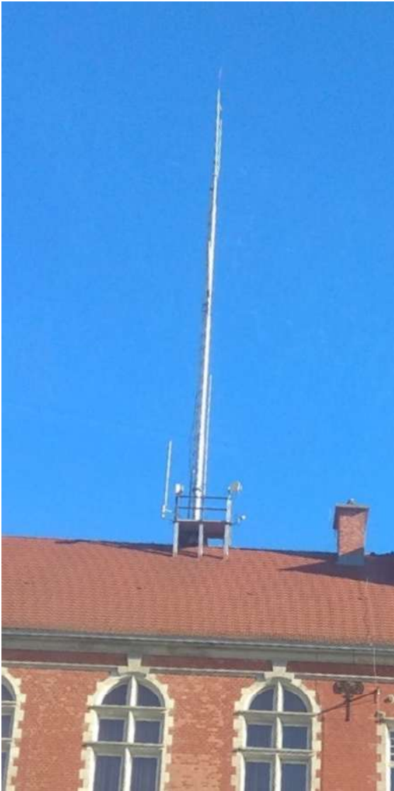
Widok obiektu wraz z zainstalowanym zespołem antenowym
