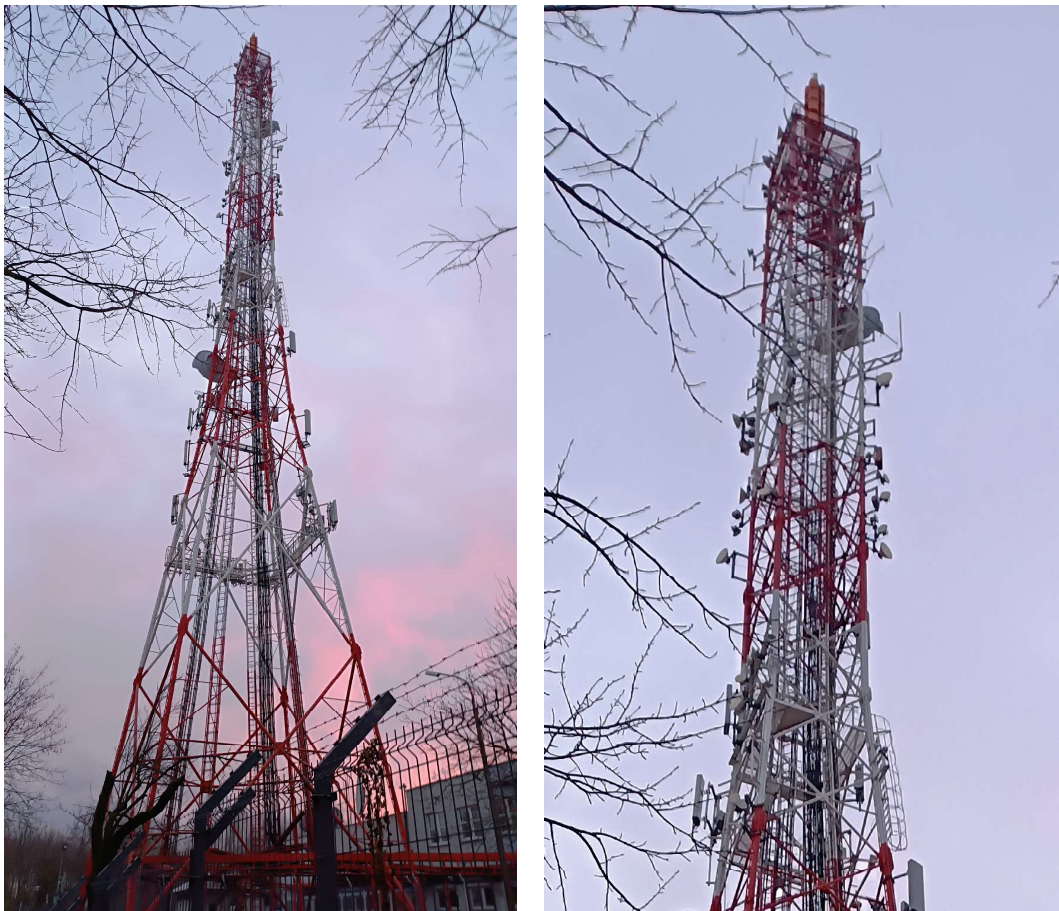
Widok obiektu wraz z zainstalowanym zespołem antenowym
