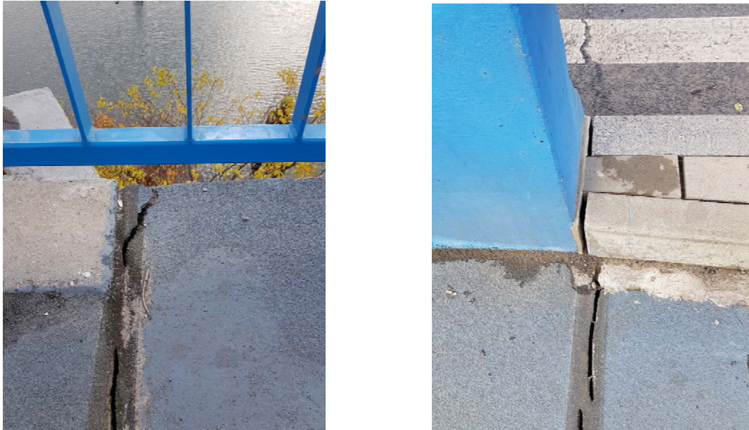
Rys. 14. Spękania nawierzchni chodników w połączeniu przyczółka z korpusem drogowym
