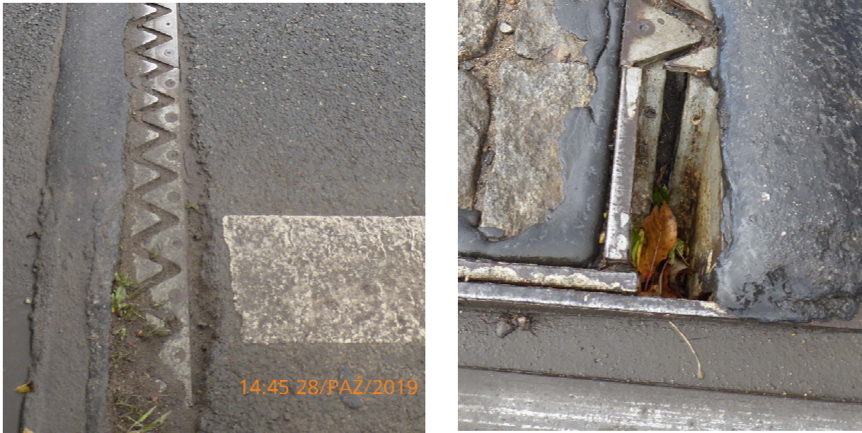
Rys.7. Zanieczyszczona szczelina dylatacyjna – stan 28.10.2019
