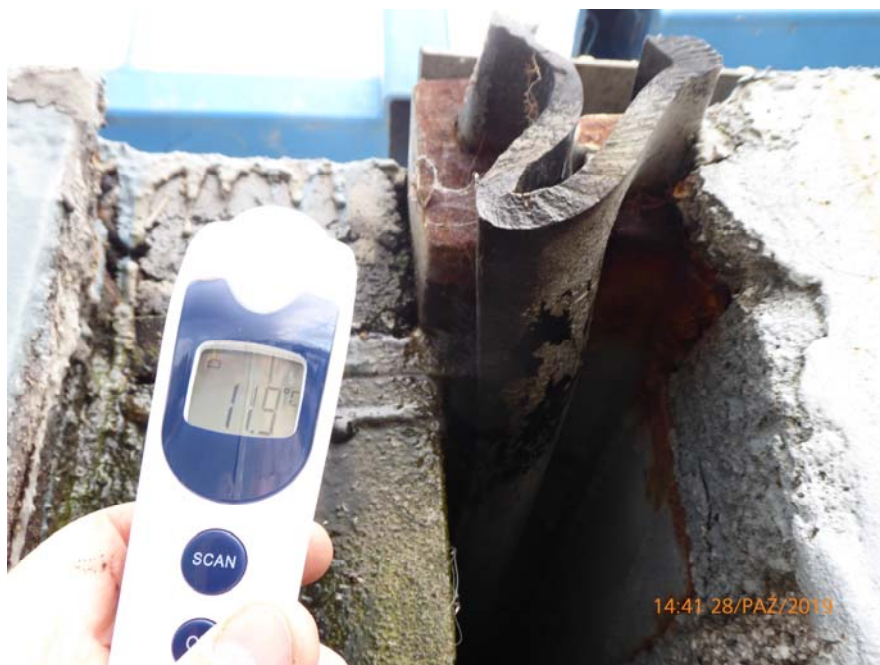
Rys. 9. Zakleszczona dylatacja od strony Petrobalticu. Temperatura konstrukcji 11.9 st.C.
