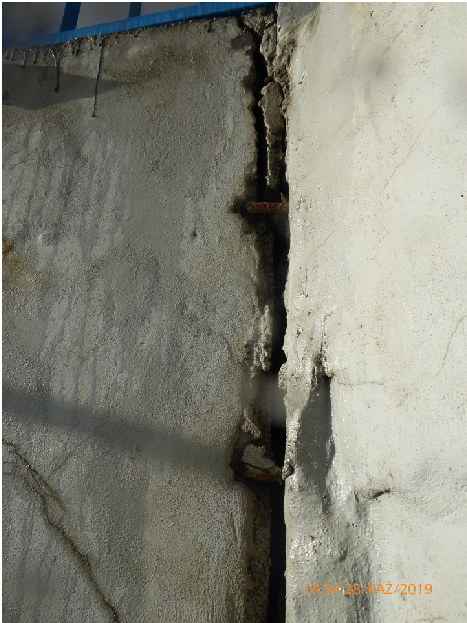
Rys. 16. Przykładowe spękania ściany przyczółka w połączeniu z murem oporowym
