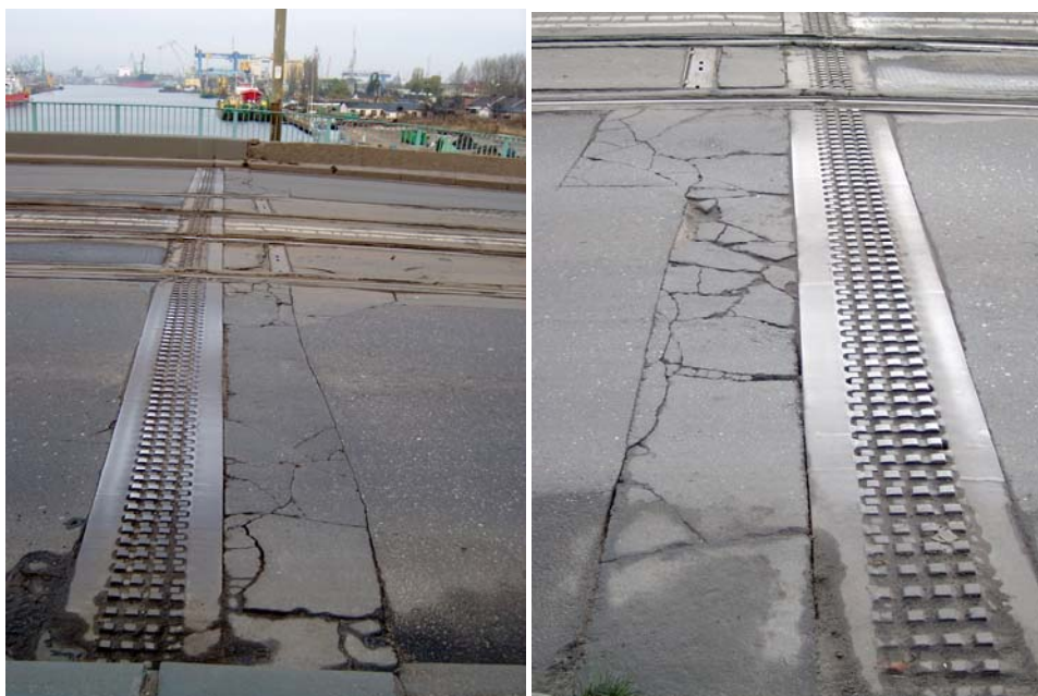
Rys.5 Pierwotna dylatacja na moście [4]
