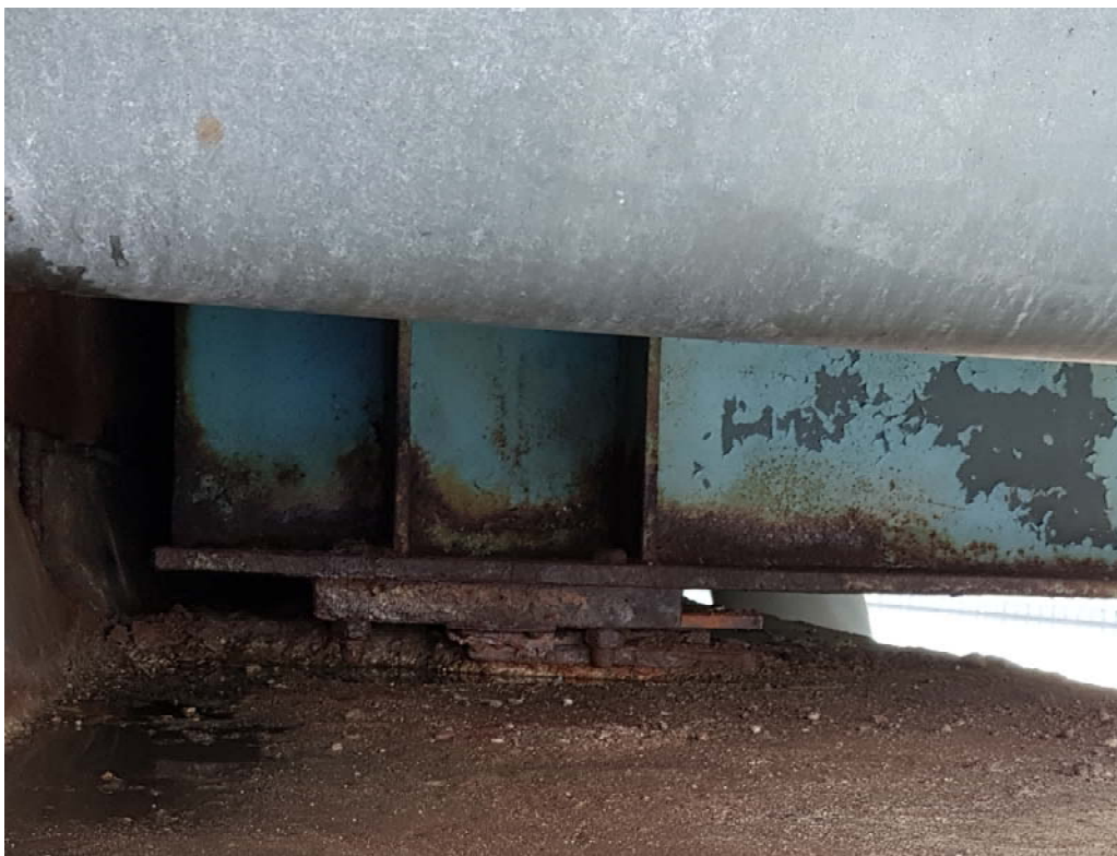
Rys. 11. Łożysko na przyczółku od strony Gdańsk – górna woda. Przesunięcie przyczółka w stronę wody na łożysku wynosi ~182 mm
