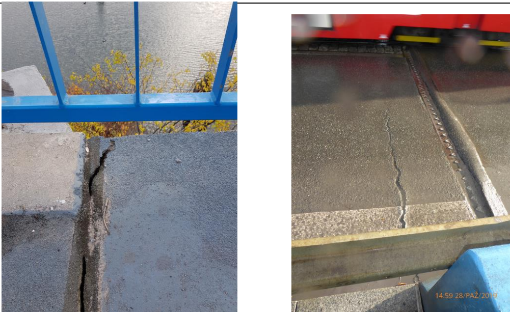
Rys. 7.9 Pęknięcia po remoncie w 2015 roku. Na lewo przyczółek zachodni (krzywa W1-W3 na wykresie). Na prawo przyczółek wschodni (krzywa E4 i E5 na wykresie)
