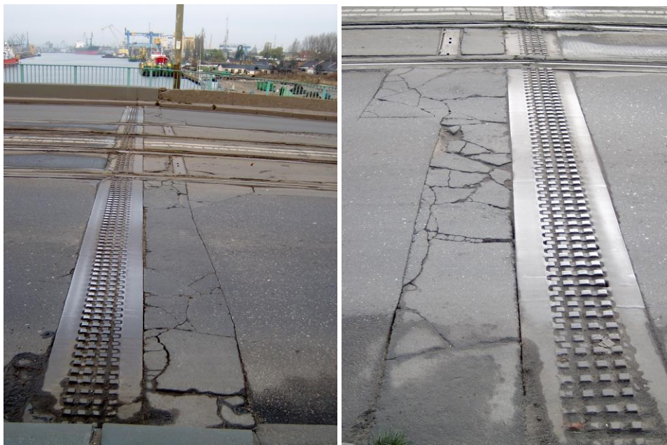
Rys. 7.5 Pierwotna dylatacja na moście [4]. Widoczne całkowite zakleszczenie przy temperaturze powietrza poniżej 10 st. C. (12.11.2004)
