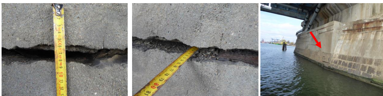
Rys. 7.10 Pęknięcia korpusu przyczółka wschodniego
