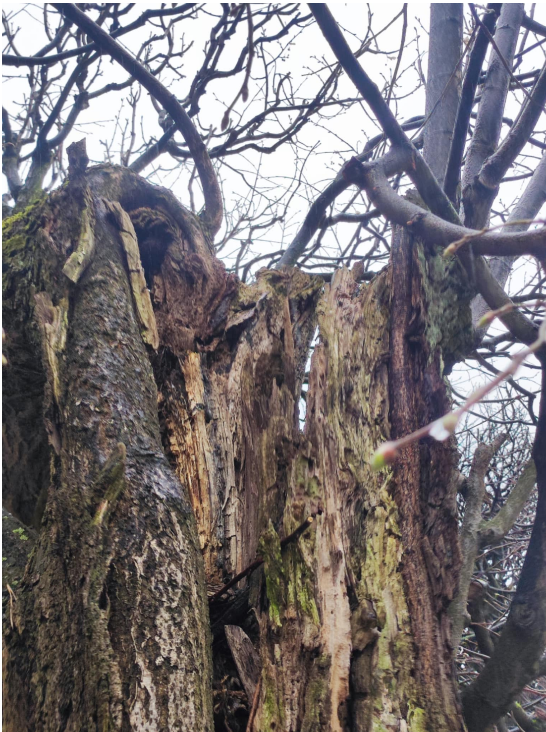
Fotografia nr 2 – wypróchnienie i pęknięcie wzdłużne pnia.
